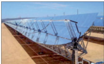
Centrale di energia solare in Marocco
