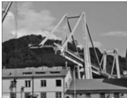
Rischi per una parte di ponte non crollata
