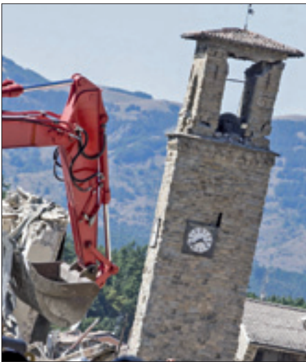
Vigili del fuoco al lavoro nei pressi della torre di Amatrice danneggiata dal sisma (Ansa)
